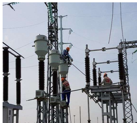
Trạm 110kV – Nam Định Vũ
