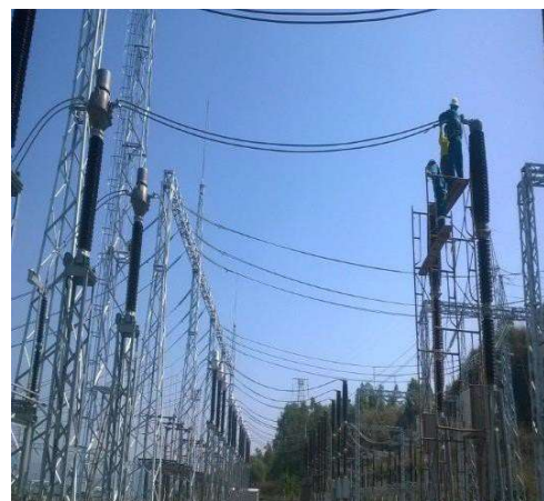
Dự án 220kv – Hòa Bình
