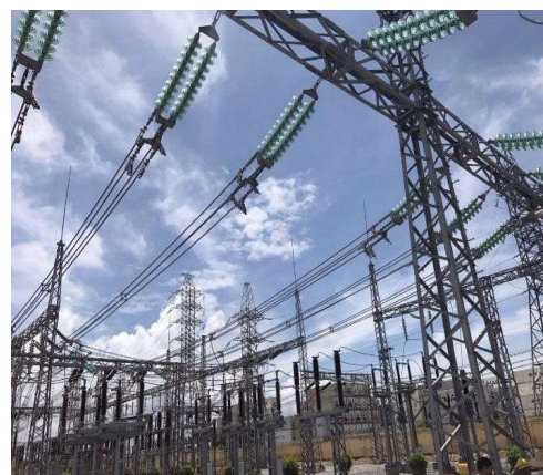
Trạm 220kV – Đình Vũ
