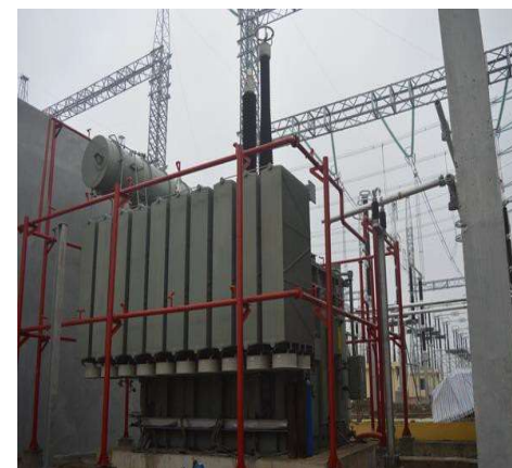
Trạm 220kV – Di Linh
